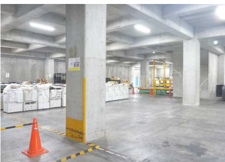
< 交換C 保管状況 3 >
